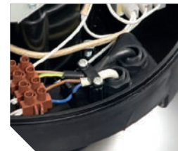
Подвод питания для рабочей и аварийной ламп
