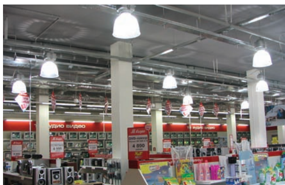
Использованы светильники: GELIODOR
