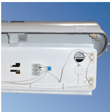
Подвес панели при обслуживании
